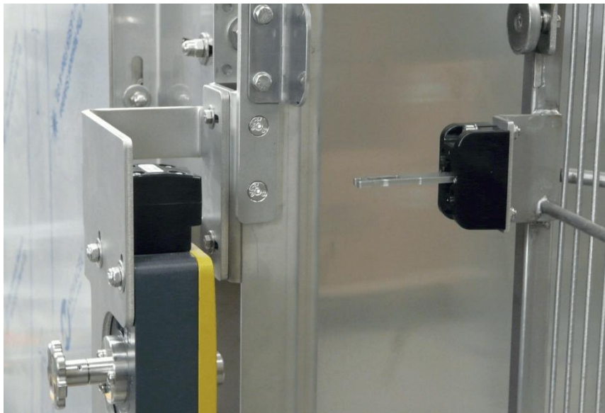
Fig. 3 Le porte di protezione degli impianti Concordia sono protette con l'Ex STM 515.
